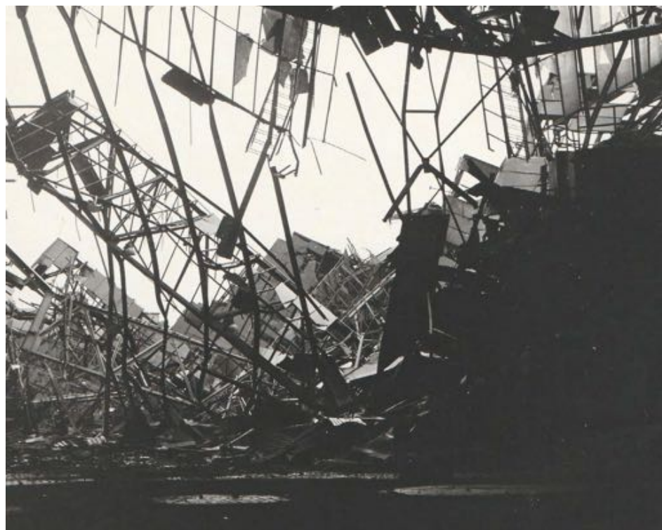
Instorting van het dak van blokvals 2 en de knuppelwalsenrij
